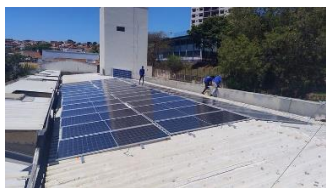
A instalação das placas solares ocorreu em outubro e a ativação do sistema, em novembro - Foto: Comunicação IPASP
